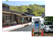
EV車等への給電設備
