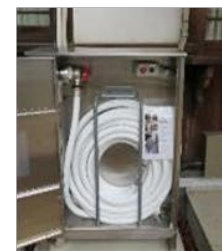
（易操作性1号消火栓）
