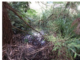
荒廃した農業用ため池
