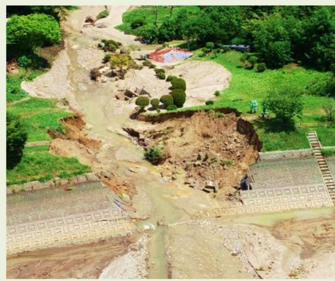
令和4年8月豪雨によるため池の決壊 (山形県川西町)
