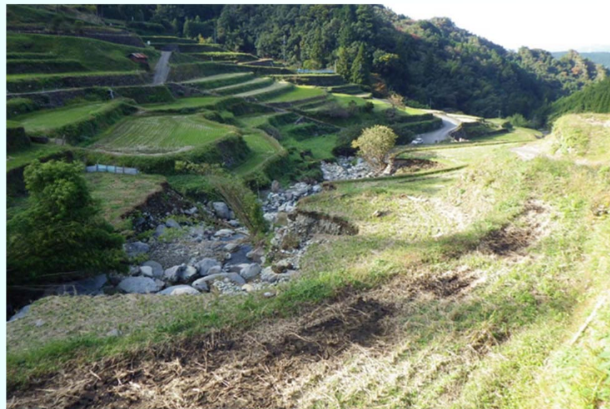
水路の崩壊(うきは市)
