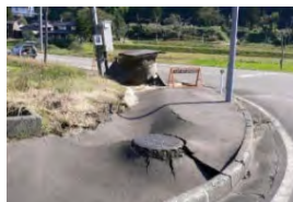
地震により被災した集落排水施設
