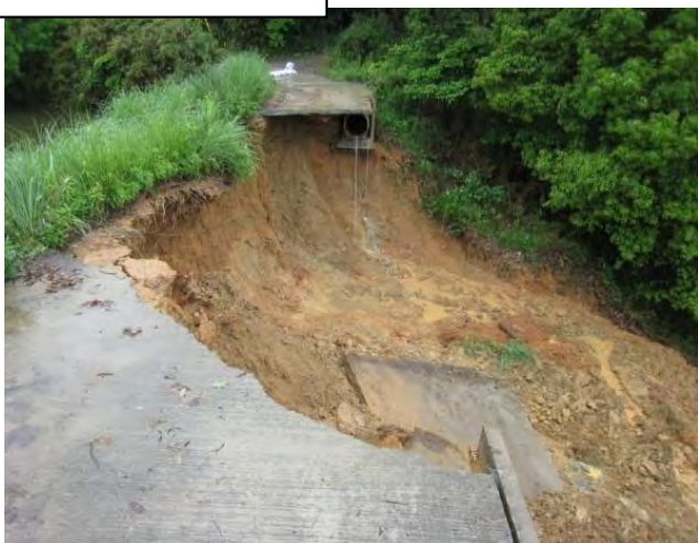
ため池法面崩壊
