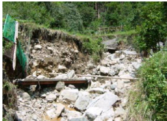
(用水路の被災)
