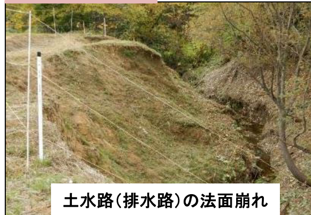
被災状況(水路)
