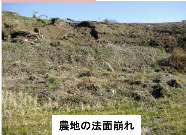
被災状況(農地)
