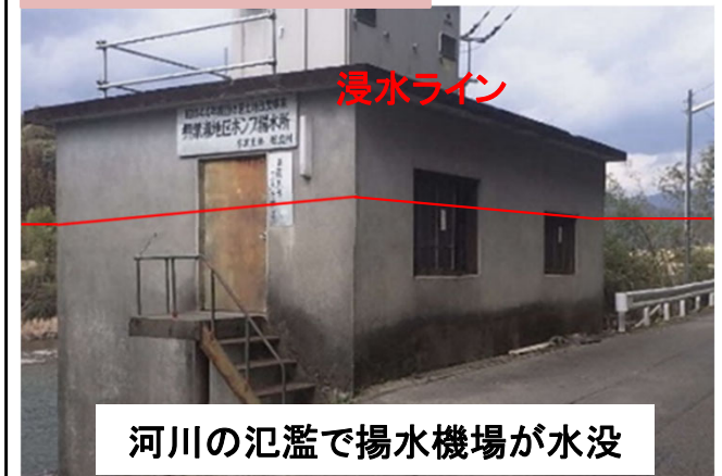
被災状況(揚水機場)
