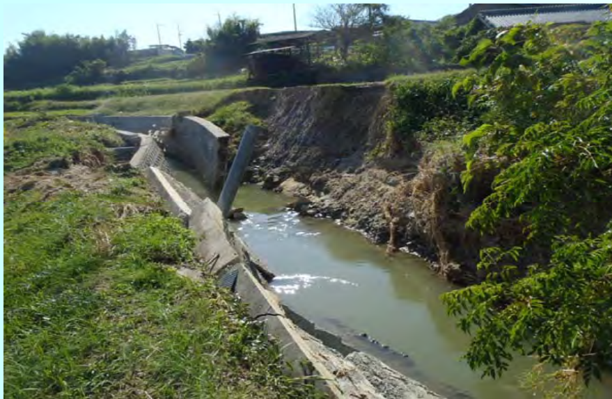
水路の被災(10月 兵庫県洲本市)
