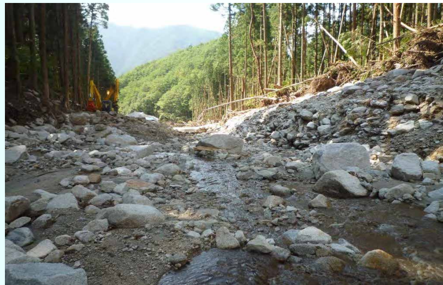
頭首工の被災(7月 長野県南木曾町)
