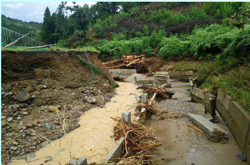
水路の被災(8月 京都府福知山市)
