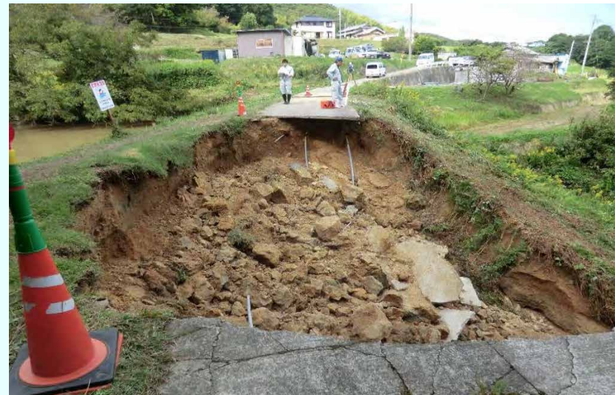
ため池の被災(10月 兵庫県洲本市)
