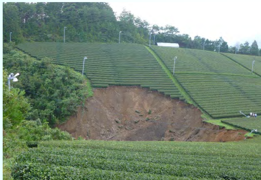
茶畑の法面崩壊(8月 高知県中土佐町)
