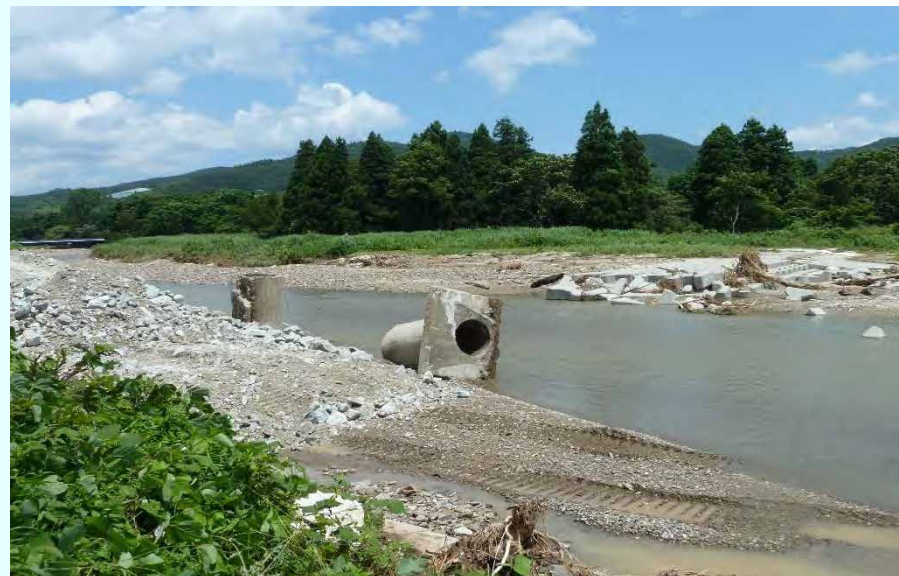
頭首工の被災(7月 山形県南陽市)
