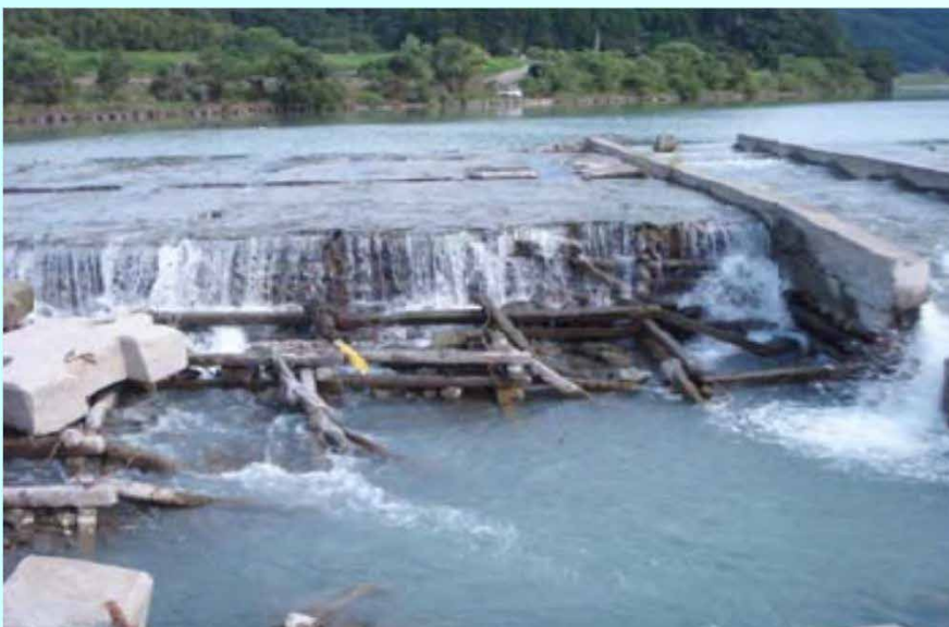
頭首工の被災(8月 徳島県阿南市)
