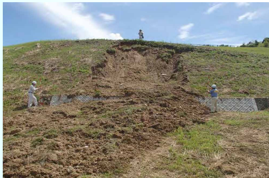
ため池の被災(8月 三重県津市)
