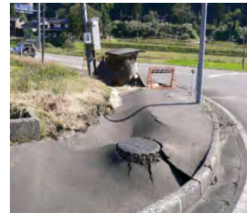
地震により被災した集落排水施設
