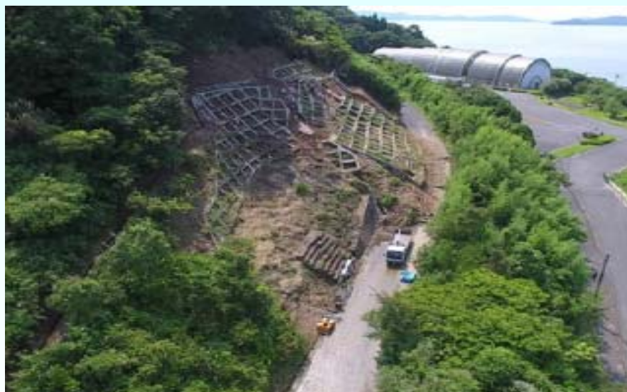
農道の被災(6月 梅雨前線 山口県光市)
