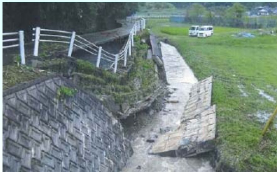
水路の被災(7月 岡山県真庭市)
