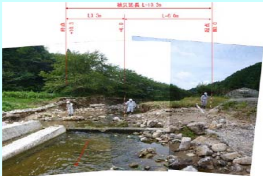
頭首工の被災(7月 島根県大田市)
