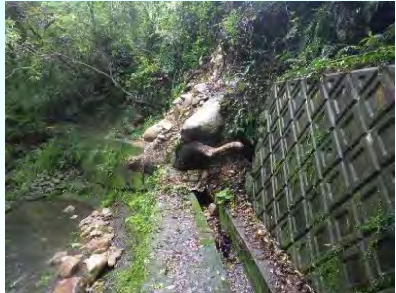
用水路の被災(10月 台風24号 三重県御浜町)
