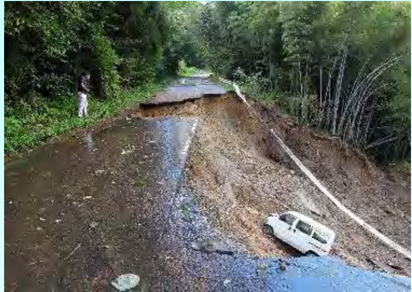
農道の被災(10月 台風24号 鳥取県青谷町)
