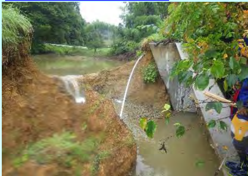
ため池の被災(7月 梅雨前線 岩手県奥州市)
