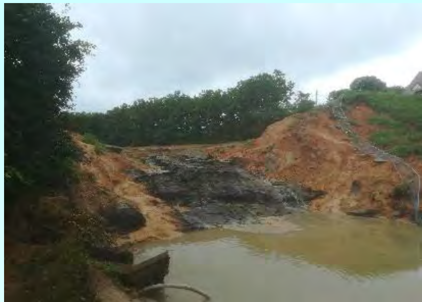
ため池の被災(7月 梅雨前線 福岡県筑前町)
