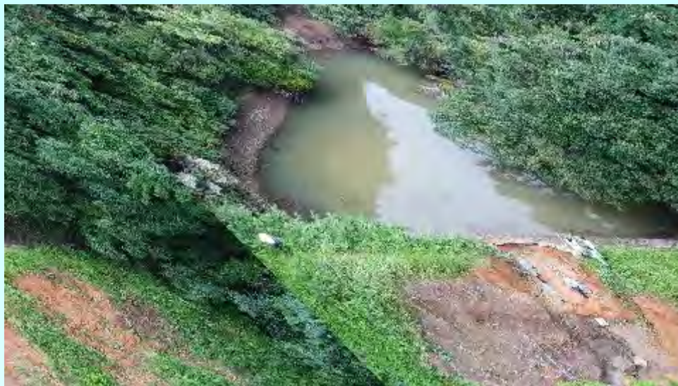
ため池の被災(8月 豪雨災害 石川県志賀市)
