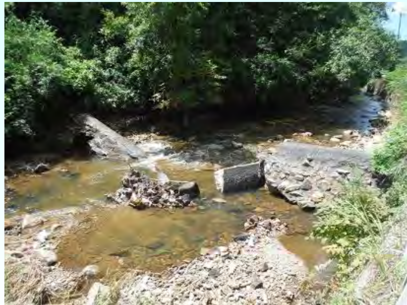
頭首工の被災(7月 台風12号 奈良県奈良市)
