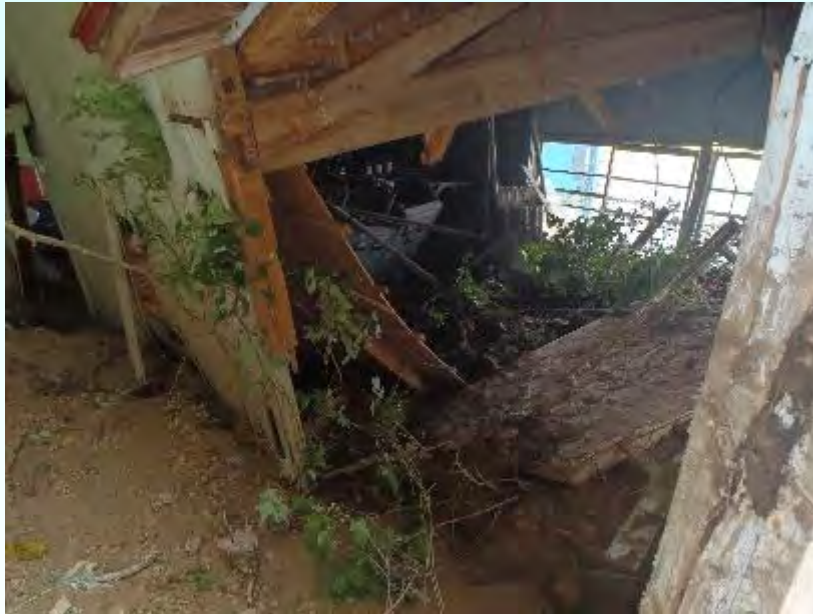
揚水機場の被災(8月 豪雨災害 山形県鮭川村)
