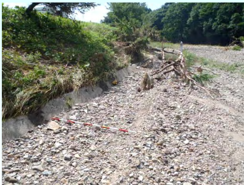
水路工の被災(7月 梅雨前線 広島県三次市)
