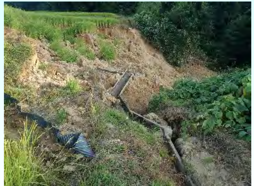
農地と用水路の被災(8月 豪雨災害 山形県鮭川村)
