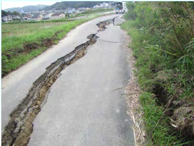
農道の被災(10月 台風24号 兵庫県洲本市)
