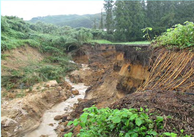
用水路の被災(9月 台風24号 宮崎県都城市)
