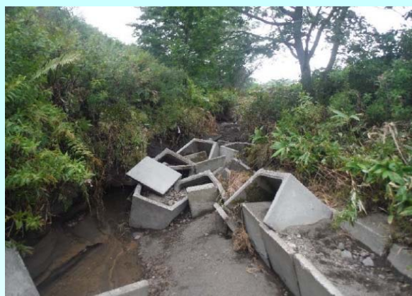
水路の被災(8月 北海道弟子屈町)
