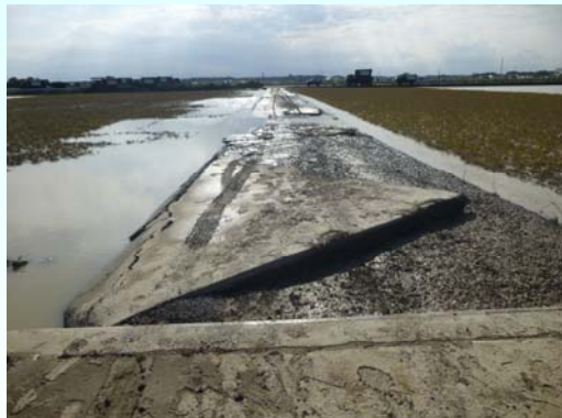
農道の被災(9月 茨城県常総市)
