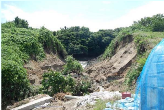
ため池の被災(7月 兵庫県淡路市)
