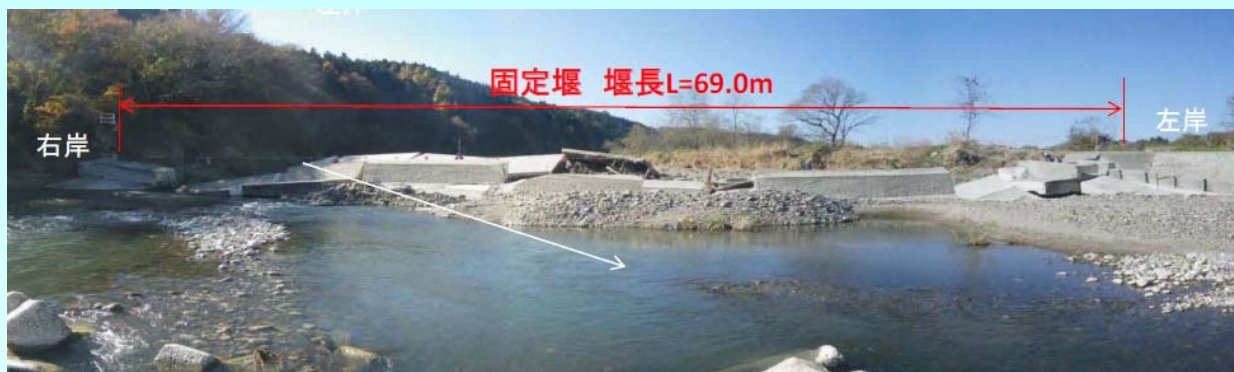
頭首工の被災(9月 宮城県加美町)
