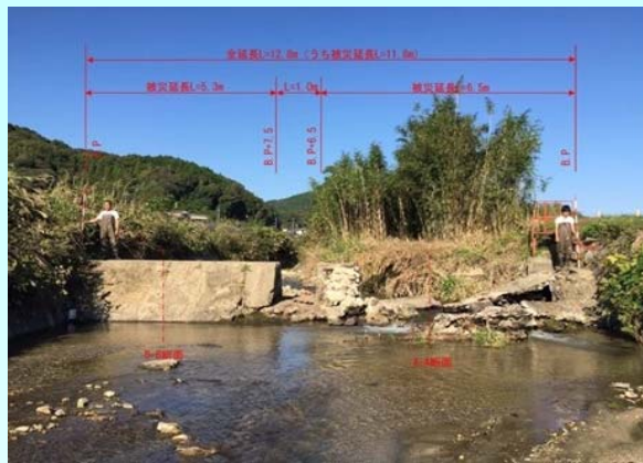
頭首工の被災(8月 台風15号 山口県光市)
