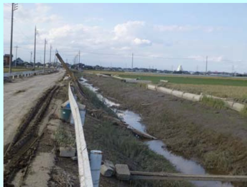
水路の被災(9月 茨城県常総市)
