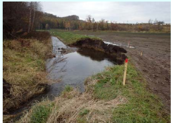
水路の被災(10月 北海道美幌町)
