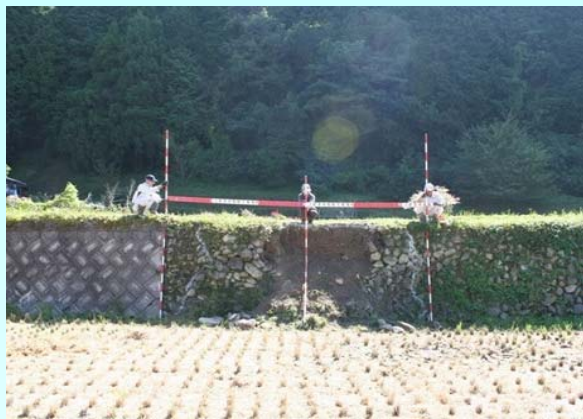
水田の被災(8月 岡山県真庭市)
