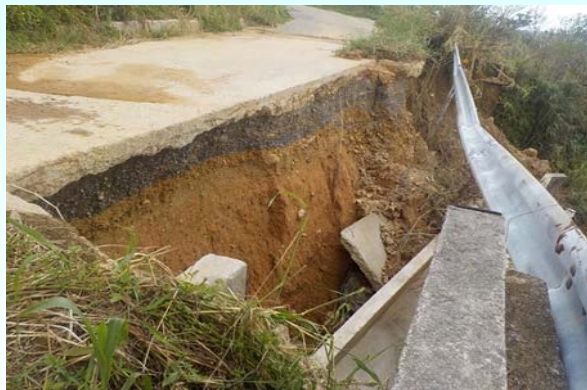
農道の被災(8月 台風15号 沖縄県石垣市)
