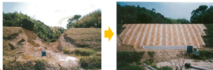
ため池の災害と復旧
