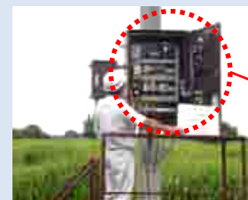
浸水した揚水機場の制御盤の部品を交換することによりポンプ機能を回復
