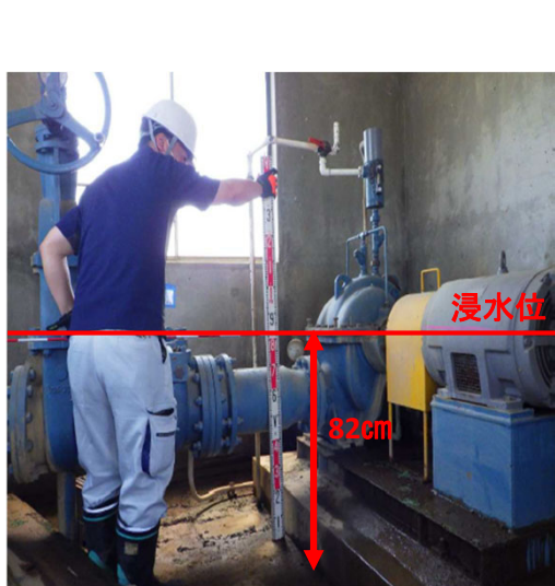
主ポンプ及び真空ポンプ
