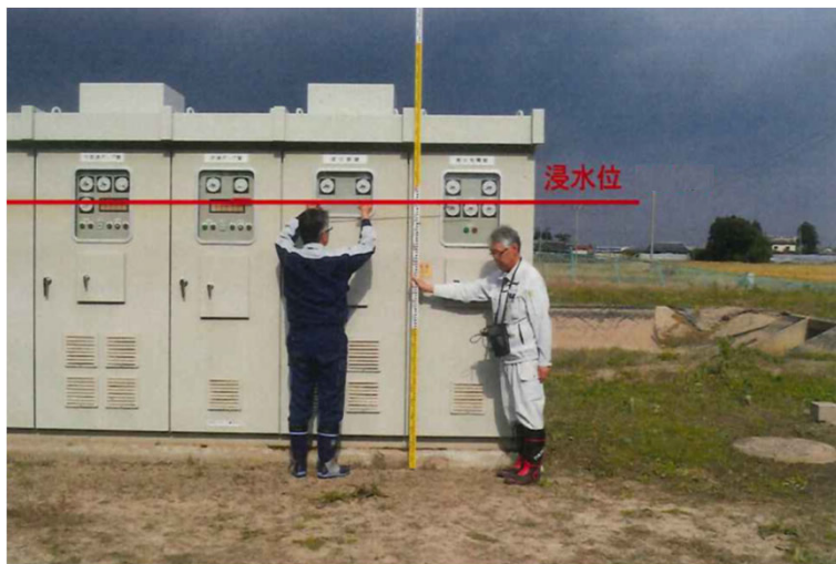
被災した電気設備（操作盤）
