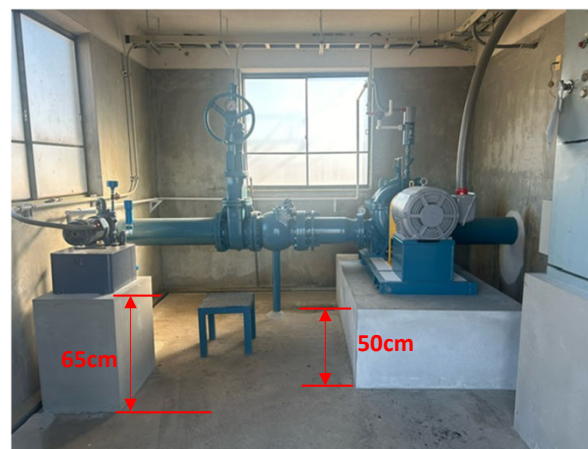
主ポンプ及び真空ポンプ
