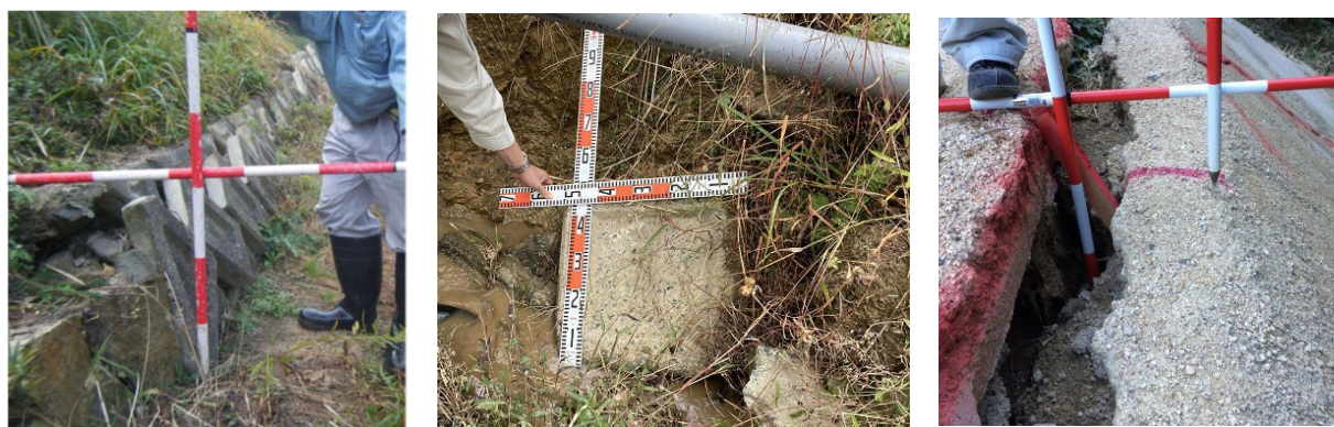
図4-15 被災した構造物の拡大写真の例
