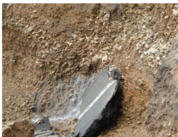
図4-17 崩壊面からの湧水発生状況の例
