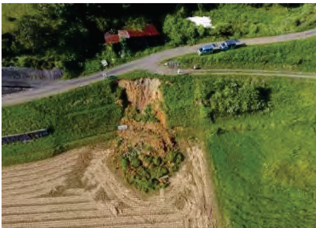
法面崩壊、堤体の崩壊 【スマートフォン等の主な対象となる形態】
