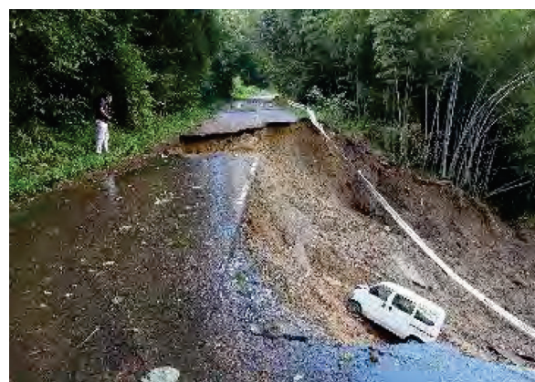
危険な場所：スマートフォン等での撮影は危険。樹木等に遮蔽されてUAV撮影ができない場合も(現場条件をみて判断となる)。
