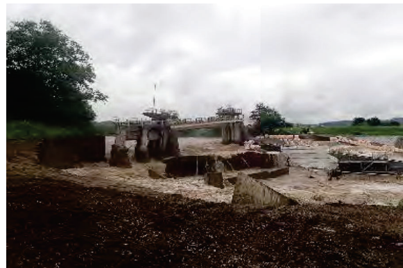
頭首工、ポンプ場等(水がある、復旧には実施設計が必要。三次元の必要性が低い)
