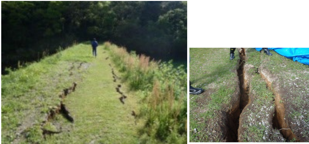
写真 2-8-4 堤体のき裂被害（熊本地震(H28.4)）
