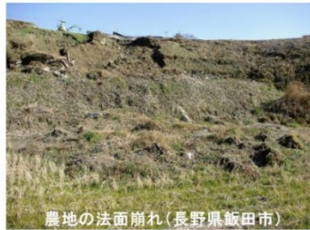
農地の法面崩れ(長野県飯田市)
