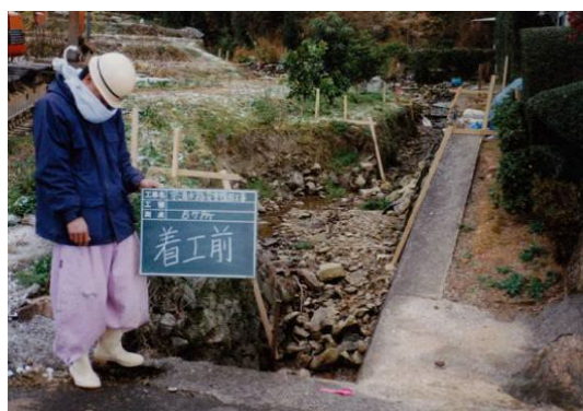
(用排水路護岸が被災し通水困難)
