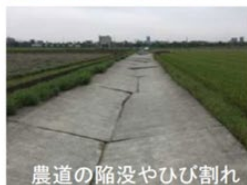
農道の陥没やひび割れ
