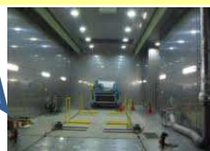
▲予冷・冷蔵貯蔵設備
