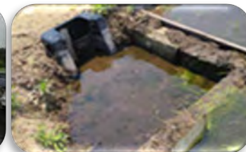
田んぼダムの設置状況
