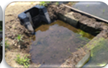
田んぼダムの設置状況
