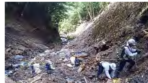
土石流センサーの設置
