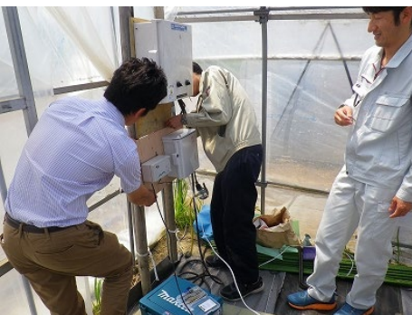
環境制御装置の設置状況
