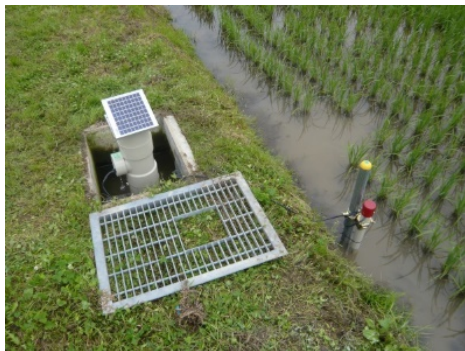
自動給排水栓検証
