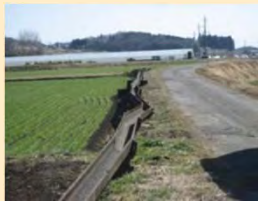
地震により受台から落下した水路
