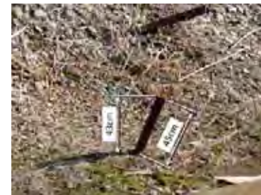
突き出たアングル（杭）
