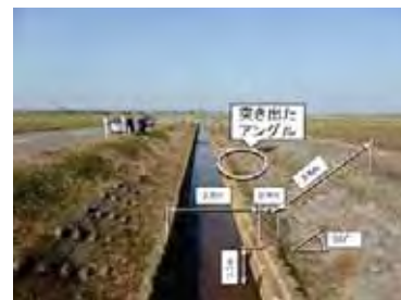
事故現場の状況
