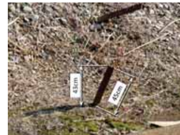
突き出たアンクル（杭）
