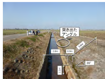
事故現場の状況
