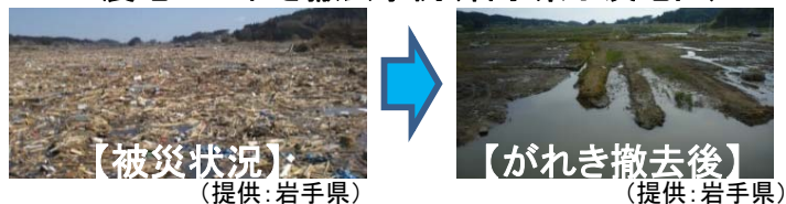
農地のがれき撤去事例(岩手県小友地区)
