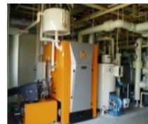
熱供給施設等での利用
