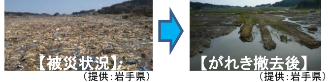
農地のがれき撤去事例(岩手県小友地区)
