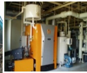
熱供給施設等での利用
