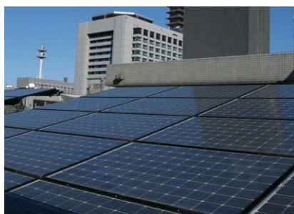
本省屋上を利用した太陽光発電
