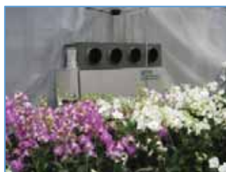
安定的採熱と ヒートポンプ利活用
