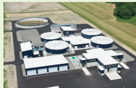
バイオマスプラント
