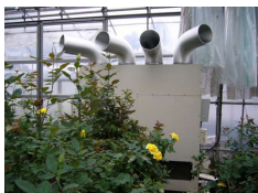
施設園芸用ヒートポンプ
