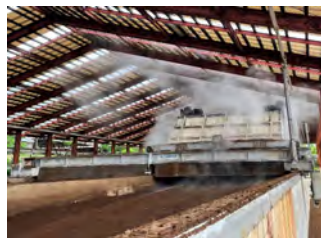
堆肥自動攪拌機
