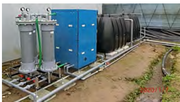
養液ろ過装置
