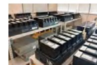
ドローンのバッテリー充電施設
