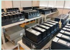
バッテリー保管・充電施設
