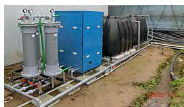
養液ろ過装置
