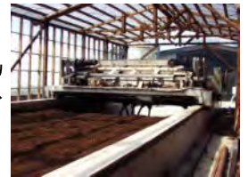
良質な堆肥を供給する 堆肥処理施設等
