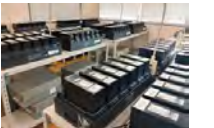
ドローンのバッテリー充電施設
