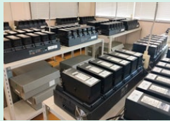
バッテリー保管・充電施設
