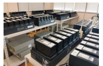
ドローンのバッテリー充電施設
