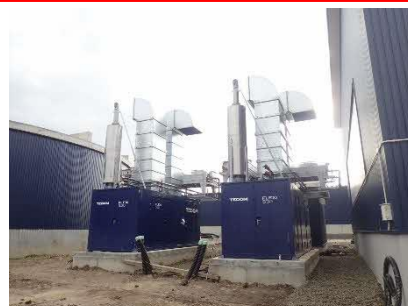
令和6年11月に設置された発電機
