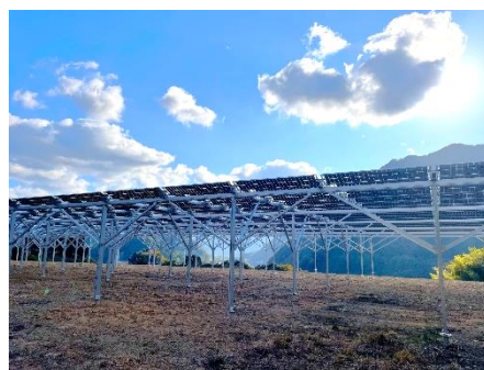
令和6年度中に農業研修施設が完成 上記は研修施設内の太陽光発電設備 複数名が研修(移住)予定
