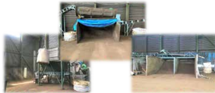
設備導入イメージ（和響エコファーム（株）益子事業所設備）
