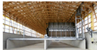
トラバーサー式ロータリー 発酵機
