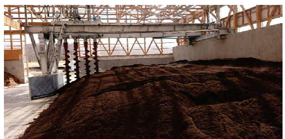
堆肥原料の自動攪拌機
