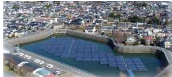
水上太陽光発電（埼玉県所沢市）
