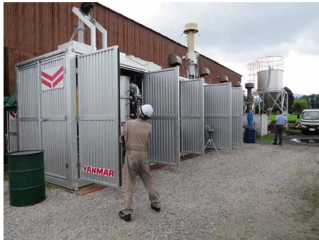
もみ殻ガス化発電施設(ヤンマーエネルギーシステム株式会社)
