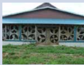
畜舎壁面の換気扇
