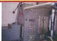
公共施設のボイラー
