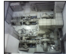
水車・発電機
