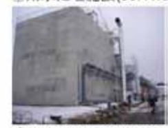
② 排水嫌気槽(08.11.30)
