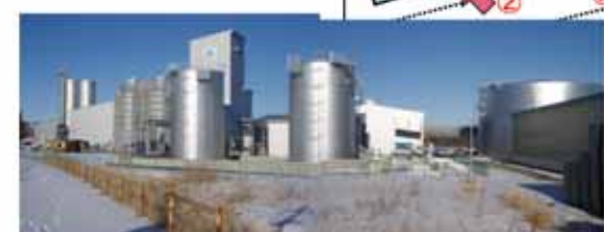
④ 製品タンク、発酵槽、蒸留・脱水棟、糖液貯蔵タンク
