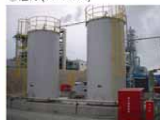
②エタノール貯蔵タンク
